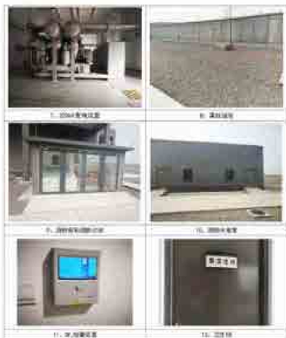
图 3-2：220kV 东园站站内环境照片
